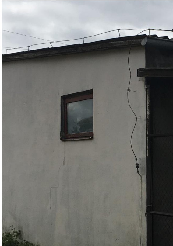
fot.7 Istniejąca drewniana stolarka okienna – Obiekt nr 4
