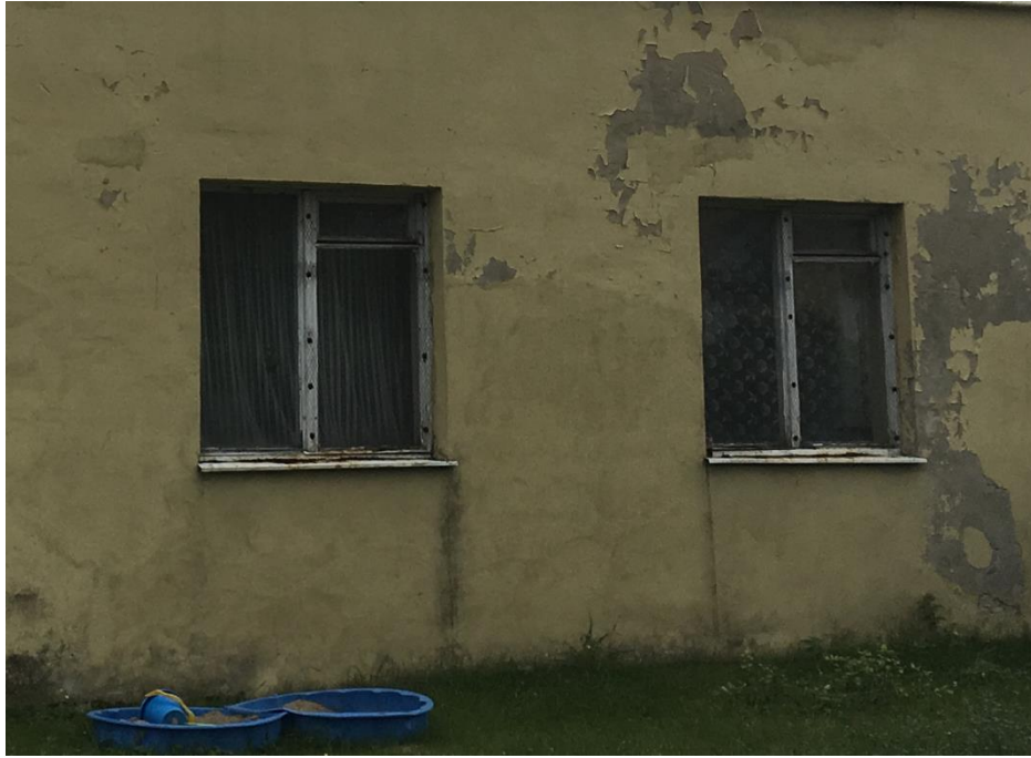
fot.5 Istniejąca drewniana stolarka okienna – Obiekt nr 1
