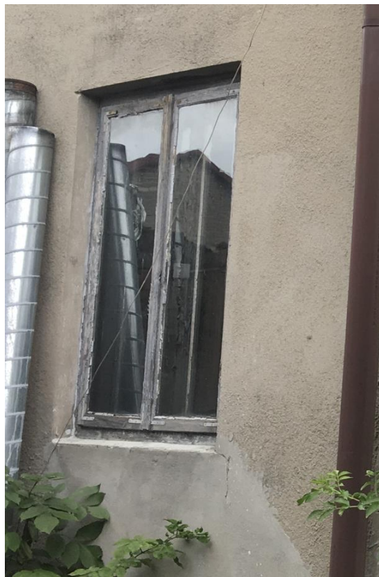
fot.6 Istniejąca drewniana stolarka okienna – Obiekt nr 2
